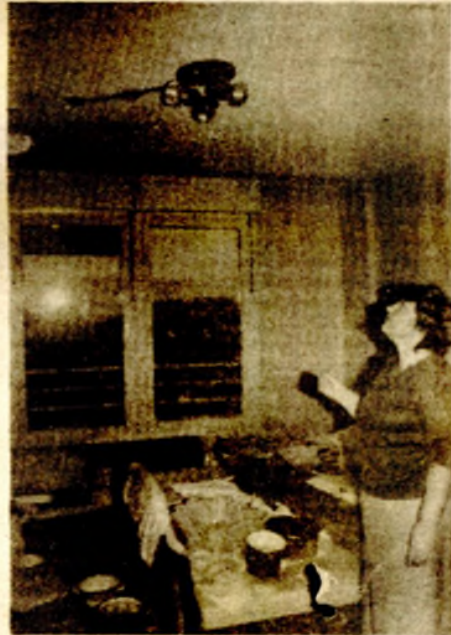
U stanu Arife Kovačević voda je oštećila plafon, parket, instalacije i kompletan namještaj
