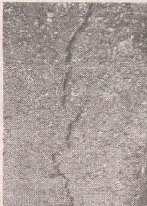
Od eksplozije je odronjen dio obale i oštećen put
