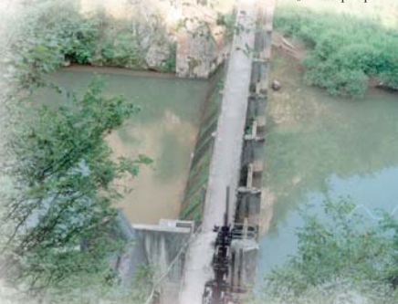
Хидроелектрана "Месићи": Рекордна производња
