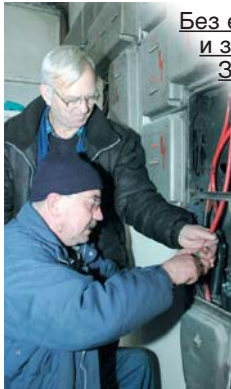
Мајстори поправљају квар: Изгорјио главни кабл (Снимео М. ЗУБОВИЋ)
