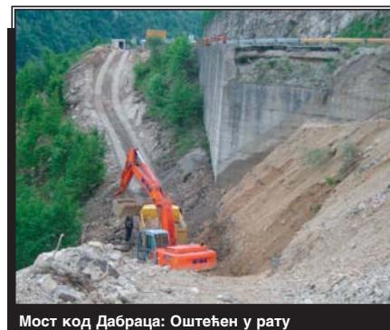
Мост код Дабраца: Оштећен у рату
