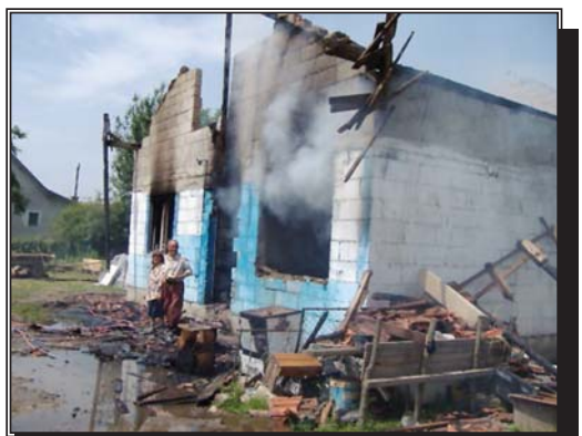
Згариште: Пожар изазвале електричне инсталације
