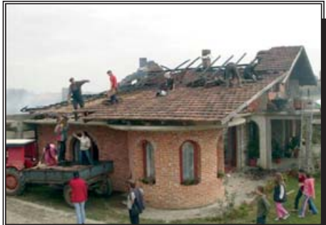
Јутро после: Уништен кров
