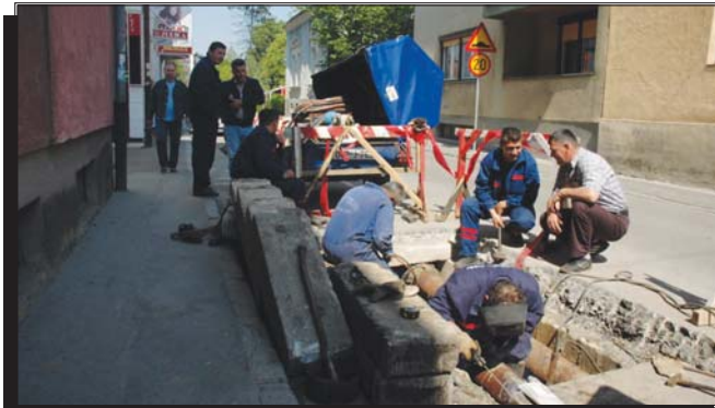
Измјена цијеви: Омогућује квалитетније снабдијевање топлотном енергијом
