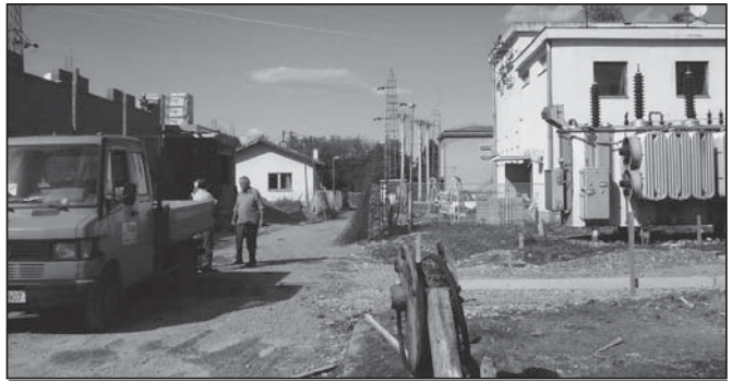
Трафо-станица: У току реконструкција
