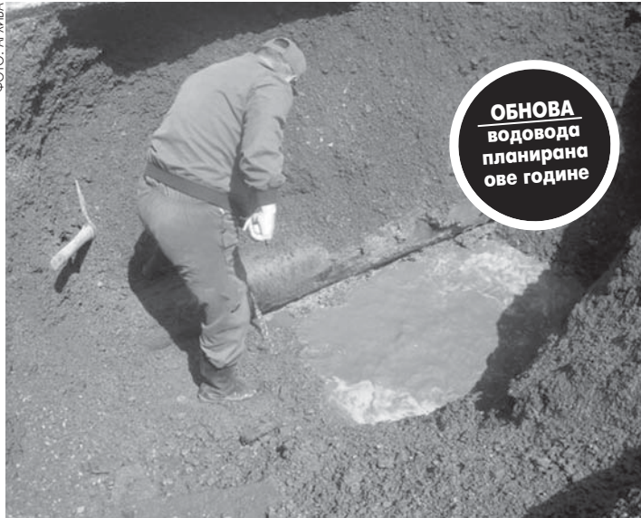
Водоводне цијеви често пуцају
