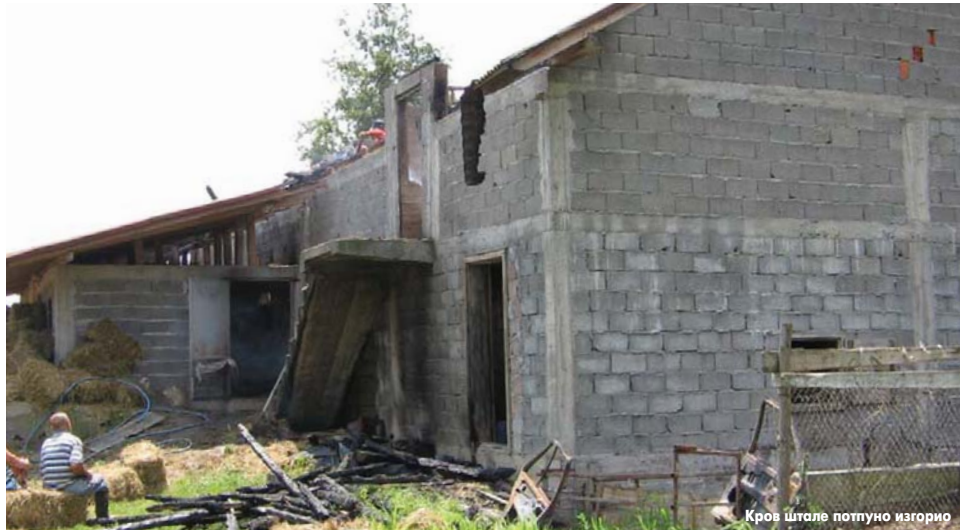
Кров штале потпуно изгорио
