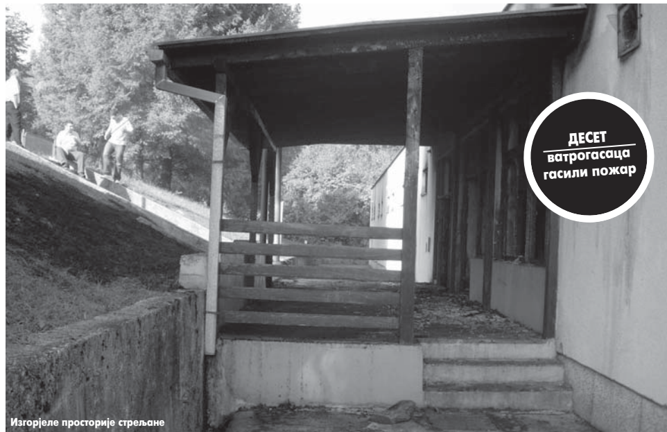
Изгорјеле просторије стрељане
