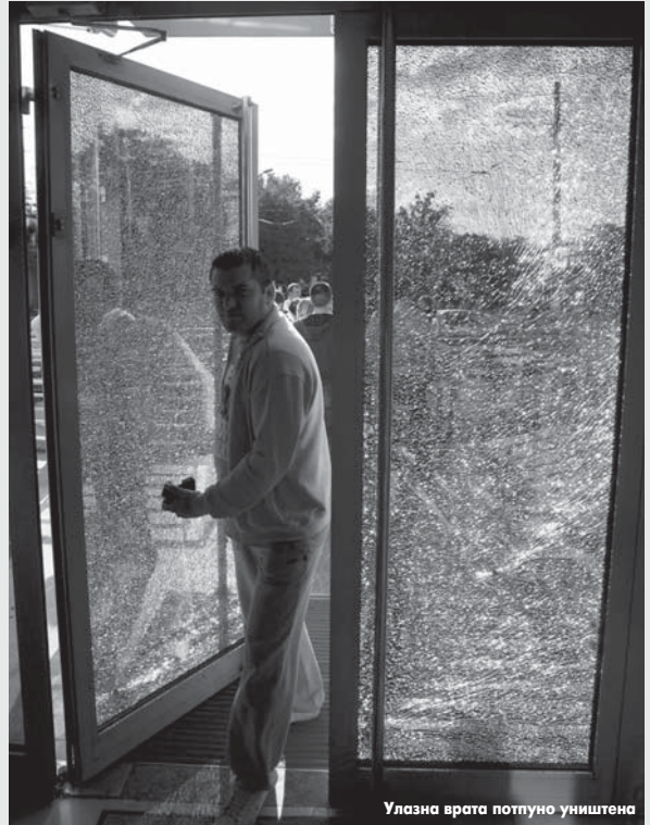
Улазна врата потпуно уништена
