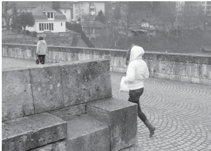
Нестао блок на ћуприји
