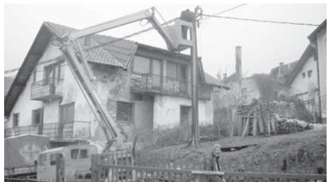
Електричари отклањају квар
