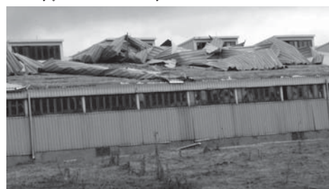
Оштећење крова на боричком овчарнику
