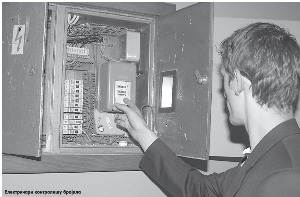
Електричари контролишу бројила
