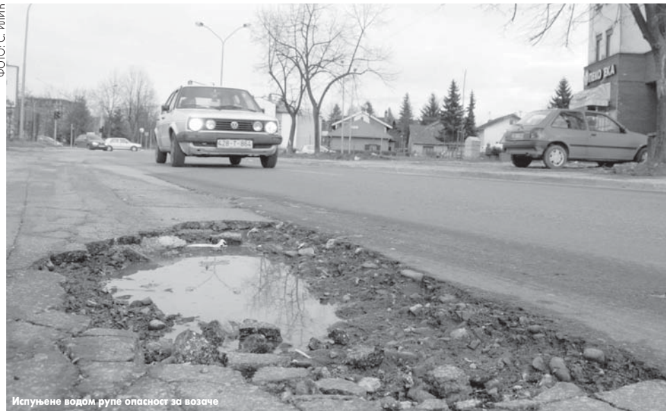
Испуњене водом рупе опасност за возаче
