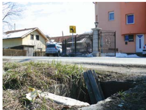
Отворен шахт поред улице
