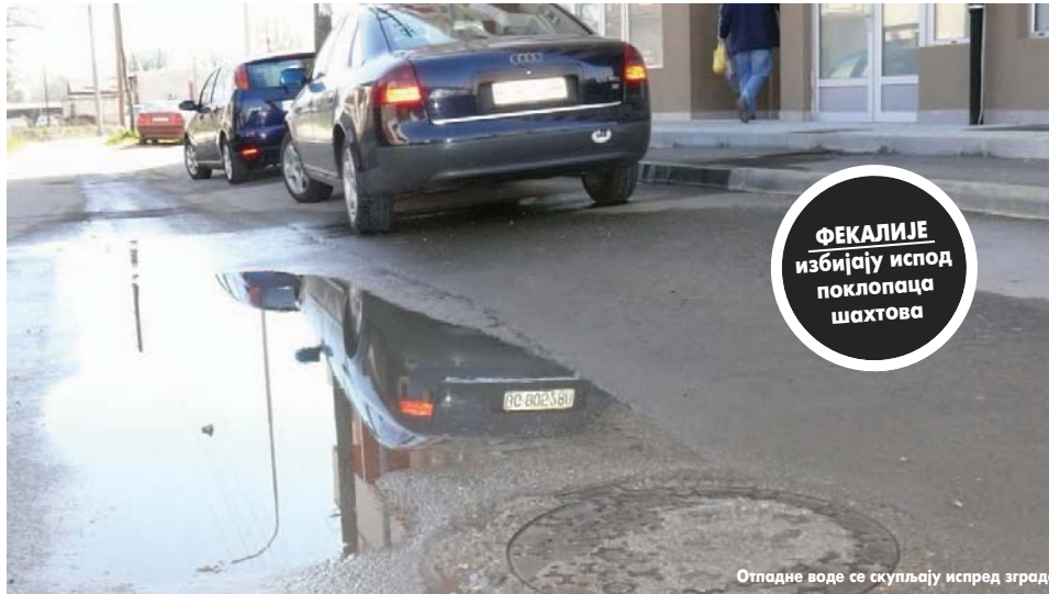
Отпадне воде се скупљају испред зграде
