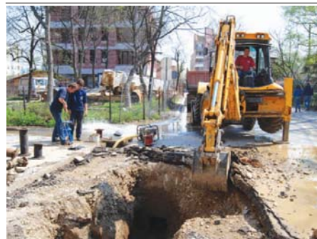
Недостаје 200 метара канализационе мреже
