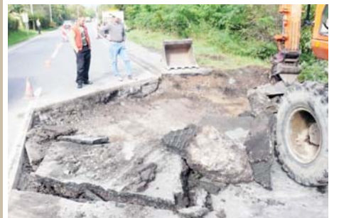
Асфалт био веома оштећен ФОТО: Н. ЛУГИЋ
