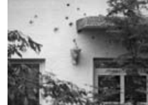
Мецима оштећена фасада
