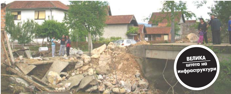
Оштећени мост на ријеци Крижевици у Братунцу
